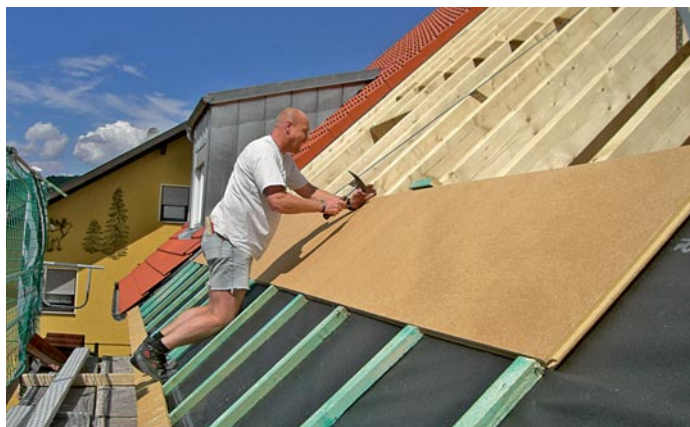
UDI TOP PŘED MONTÁŽÍ KRYTINY. DIFUZNĚ OTEVŘENÁ KONSTRUKCE SE ZAFOUKANOU CELULÓZOVOU IZOLACÍ
