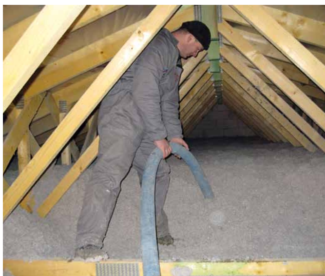
Při zafoukání členitých sbíjených vazníků dochází k dokonale celistvému zateplení beze spár a kritických míst.
