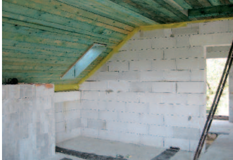
Klasické podkrovie nového rodinného domu s dreveným podbitím pred následnou povrchovou úpravou formou omietky.
