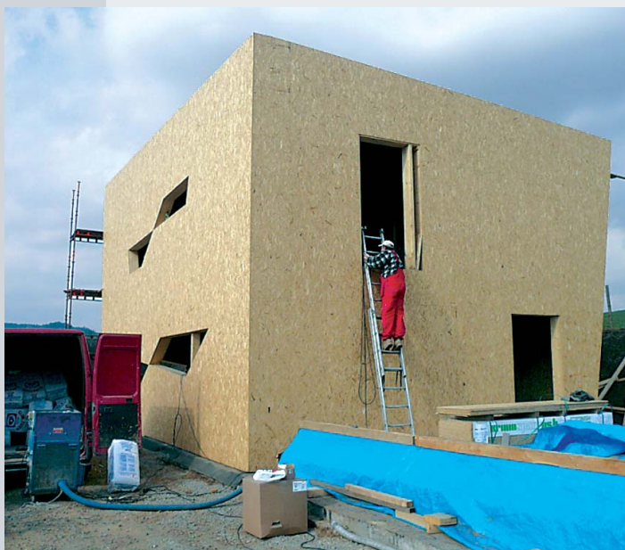
Manipulace při aplikaci na stavbě je minimální. Probíhá pomocí stroje přímo z dopravního prostředku do konstrukce.
