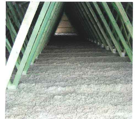
Aplikace Climatizer plus na podhledu ve styčnickové konstrukci
