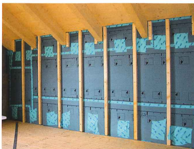
Skladba konstrukce ze strany interiéru při použití antireflexní parobrdz Pro clima DB
