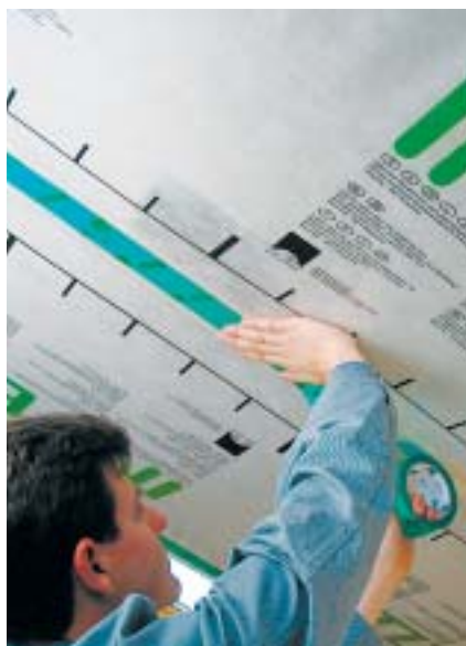
Uložení izolace na vyztuženou parobrzdý INTELO je velmi vhodnou aplikační metodou. Zároveň je zajištěna ochrana proti proudění vzduchu.
