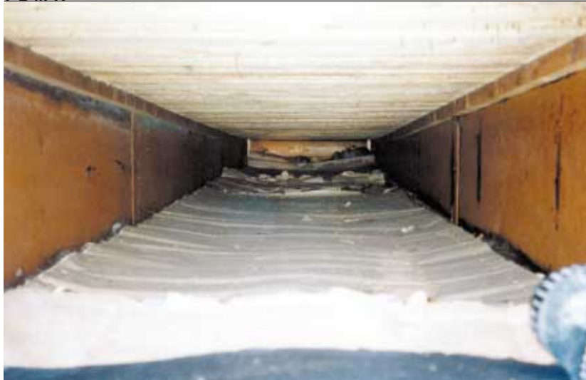
▲ Dvojplášťová strecha z lepenkových väzníkov – doizolovanie medzistrešného priestoru pred dodatočnou izoláciou. Pôvodná izolácia nebola dostatočná z hľadiska úniku tepla i hlukovej izolácie
